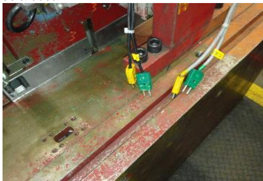
Imagen 4 Enchufes eléctricos Estandarizados
