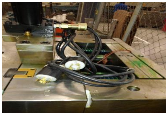
Imagen 3 eléctricos sin Estandarizar
